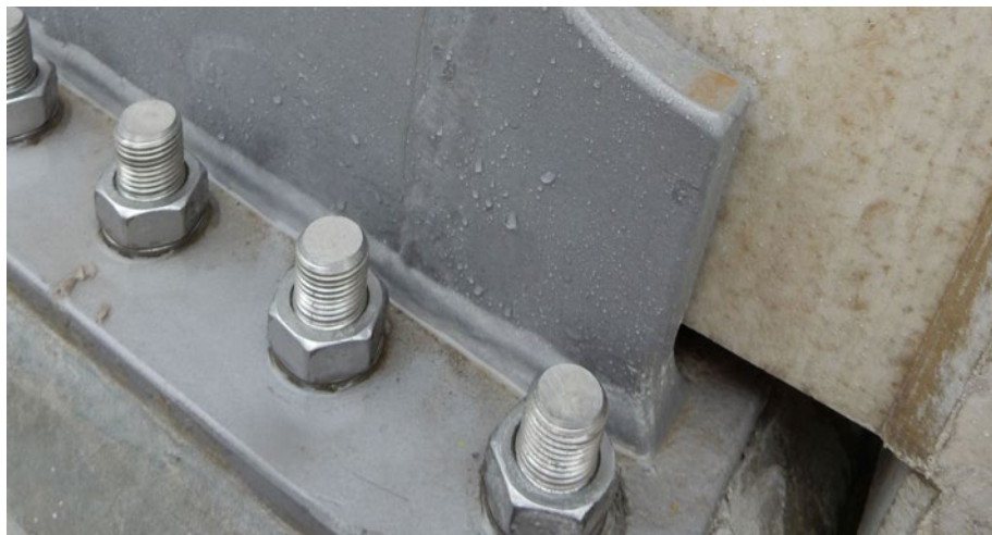
Abb. 5: Anschluss eines in die LSW integrierten OLA-Mastes
